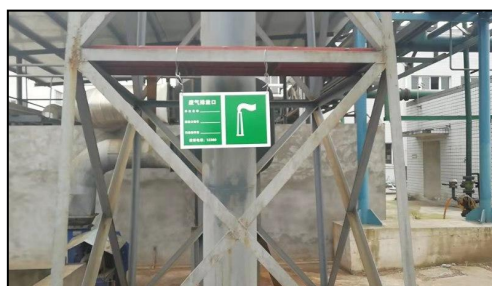
采样平台及排气筒标识牌
