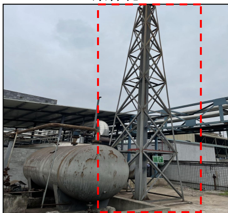
8m高排气筒
